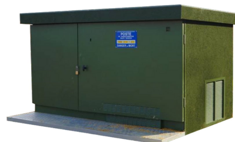
Transformateur électrique implanté au sol
